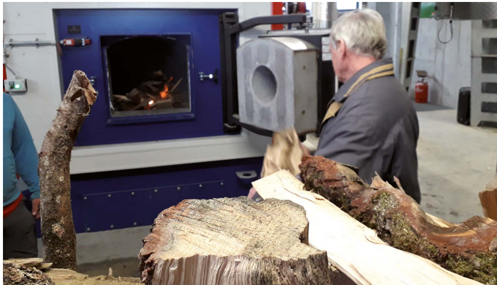
Heizzentrale der Bürgerenergie Schopfloch
